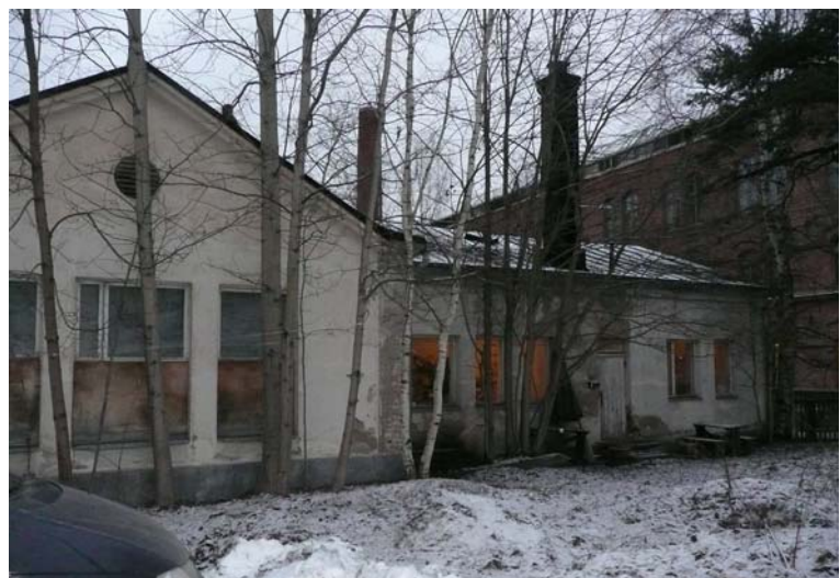
Kiviosan eteläjulkisivu. 1950-luvun modernisoinnissa vanhoja pariovia ja yläreunastaan kaarevia ikkunoita poistettiin. Kiviosan nykyiset ikkunat ovat pääosin 1950-luvulta.
